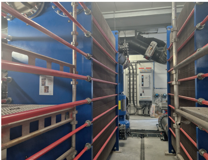
Varmevekslere med svært stor effekt varmer opp sjøvannet som kommer inn i anlegget.
