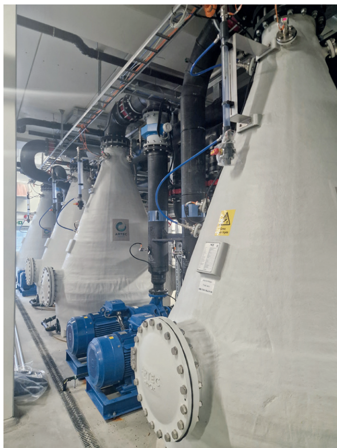
Noen av de tekniske installasjonene i byggetrinn 2.
