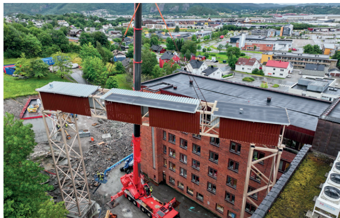
Brua i stål ble produsert ved Overhalla Mekaniske og transportert i en del før den ble heiset på plass i prosjektet. Foto: Kommunikasjonshuset Trio Media
