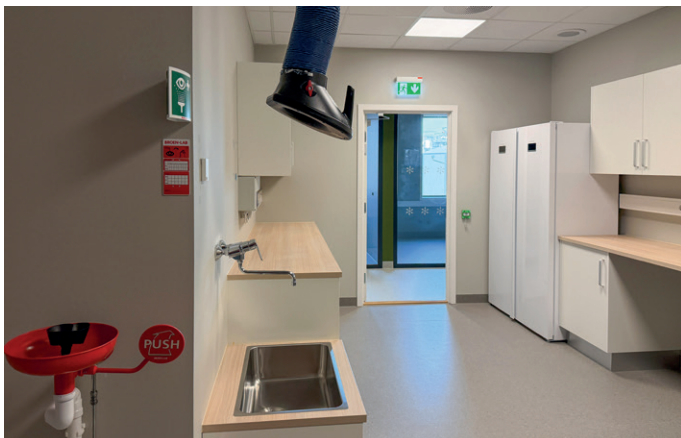
I administrasjonsrommet er det også et prøverom hvor man kan teste vannkvaliteten.
