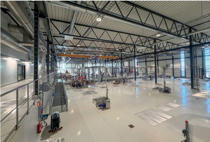
Det er stort inne i hallene i rensenanleggene. Her ser vi hvor den biologiske massen renses ut av avløpsvannet.
