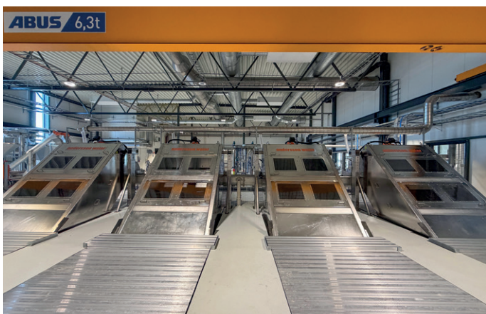
Kraner er installert i store deler av anlegget.
