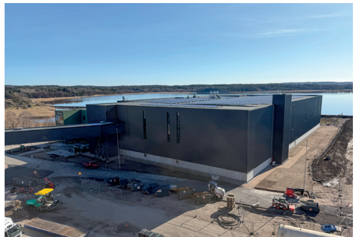
På taket av anlegget har man montert solceller.
