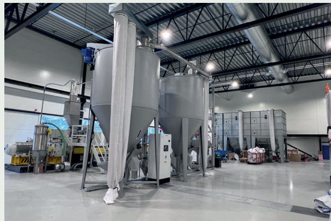
Resirkuleringsanlegget er nå i full drift.
