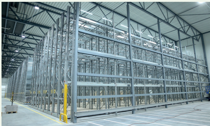
Constructor Norge har levert store mobile realsystemer som her i fryse-lageret.
