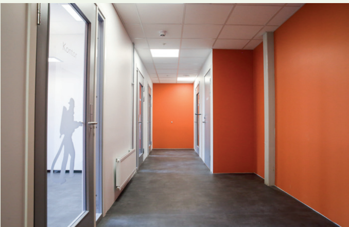
Kontordelen i andre etasje i den sorte delen av bygget. Brannsjefen får kontor inn til venstre.
