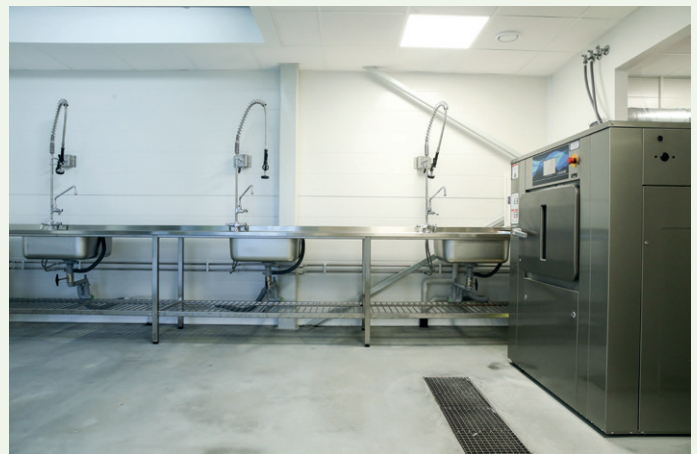
Barriereutstyr med barrieremaskin og utstyrvasker.
