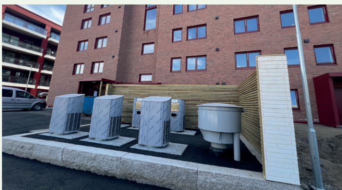
Det er etablert et søppelsuganlegg i tilknytning til utbyggingen.
