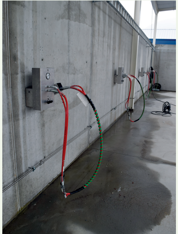
Fylleanlegg for gasscontainere.
