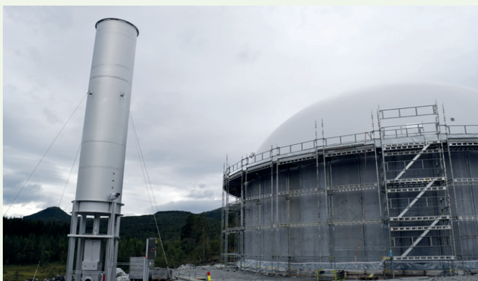
Flammetårnet med den store prosesstanken til høyre.
