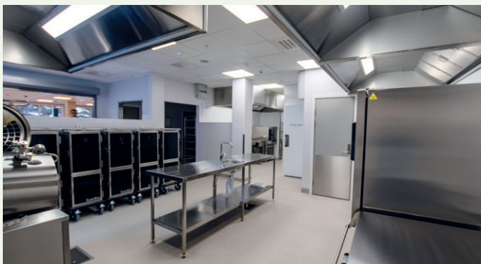
Et storkjøkken i aktivitetssenteret server hele bygget med mat.
