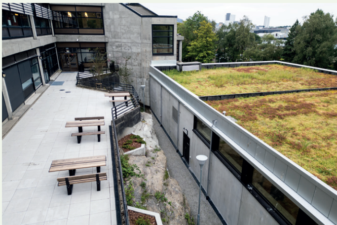
Her er betong-støtteplaten, som er festet to meter inn i fjellet. Foto: SKARP
