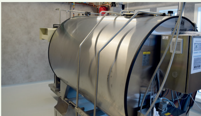
Rom for melketank med varmegjenvinning fra melka.
