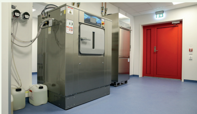
Barrierevaskemaskin og annet vaskeutstyr i dette rommet mellom skitten og ren sone i brannstasjonen.
