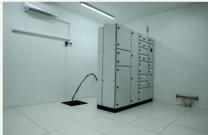
Tekniske installasjoner i lavspenntrommet i teknisk bygg på Indreeide. Aventi har ansvaret for alt av elektro.
