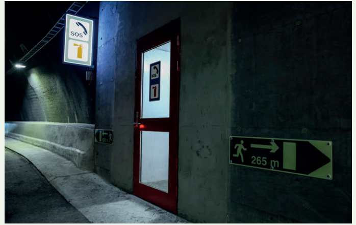
Tunnelen er bygget med moderne sikkerhetsstandard. Her ser vi noen av systemene for brannsikring, varsling og rømning.
