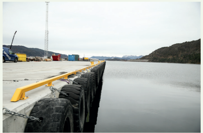
Fendersystemer og kaiutstyr er levert av Norwegian Supply & Service. Brukte hjullasterdekk fungerer til å hindre harde sammenstøt mellom frakteskip og kai.
