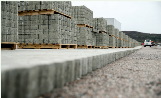
Støpt belegningsstein er ofte brukt på havneområder. Slik også på Flatholmen i Ålesund.
