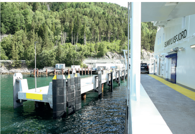
De ytterste pelene på Linge ferjekai er ført 35 meter ned til havbunnen der de er boret to meter ned i fjell.
