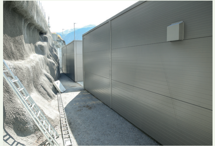
Trafostasjonen er plassert i konteinere inntil fjellet bak oppstillingsplassen for biler. Linja, tidligere Mørenett, er strømleverandør til elferjene.
