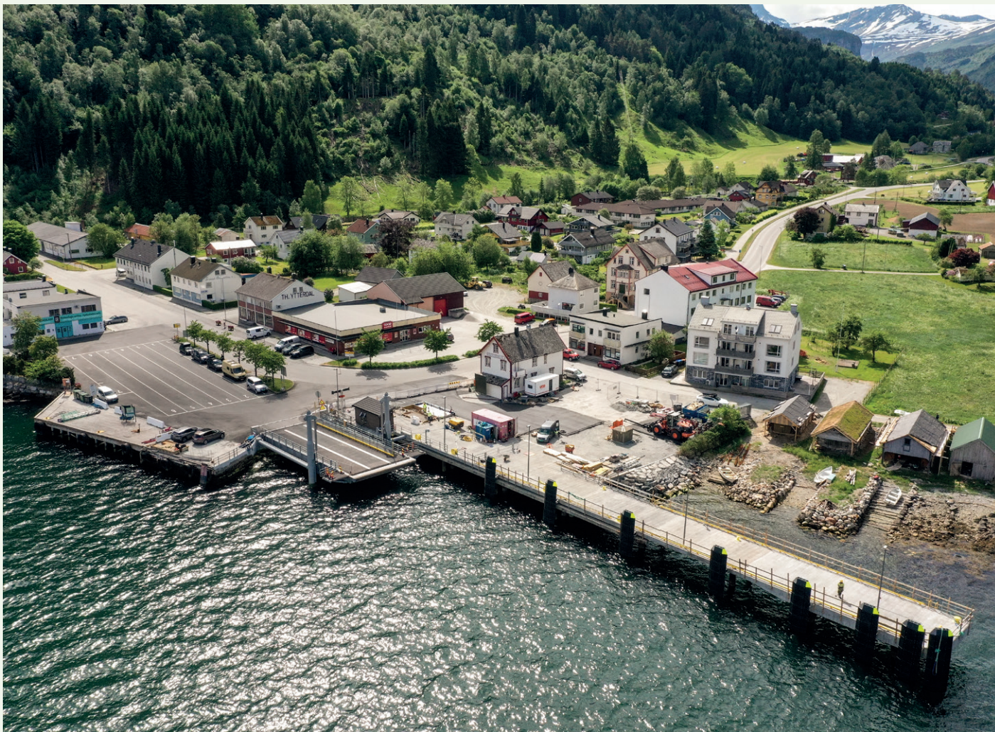
Den nye ferjekaia i Eidsdal er 62,5 meter lang og sju meter bred. Christie & Opsahl var i ferd med å bygge toalettbygg på oppdrag for Fjord1 og fylkeskommunen inne på kaia da vi var der. Ytterdal Historiske Naustlag bak kaia i høyre bildekant.
