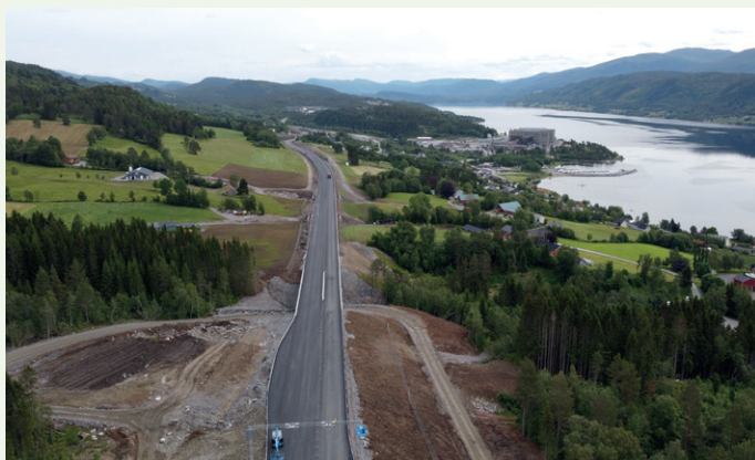
Den nye veien sett østover. Det nye Sjukehuset Nordmøre Romsdal som er under bygging til høyre mot fjorden. Foto: Statens vegvesen
