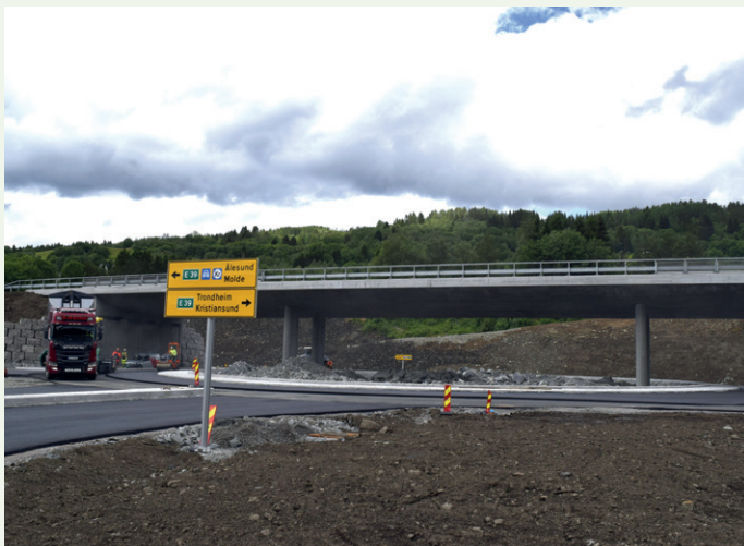
Den lengste brua lengst øst er bygd for å få plass til en rundkjøring med avkjørsel til lokale veier og nytt sykehus under.
