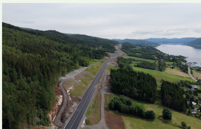
Parti av den nye veistrekningen sett fra vest mot øst. Foto: Statens vegvesen
